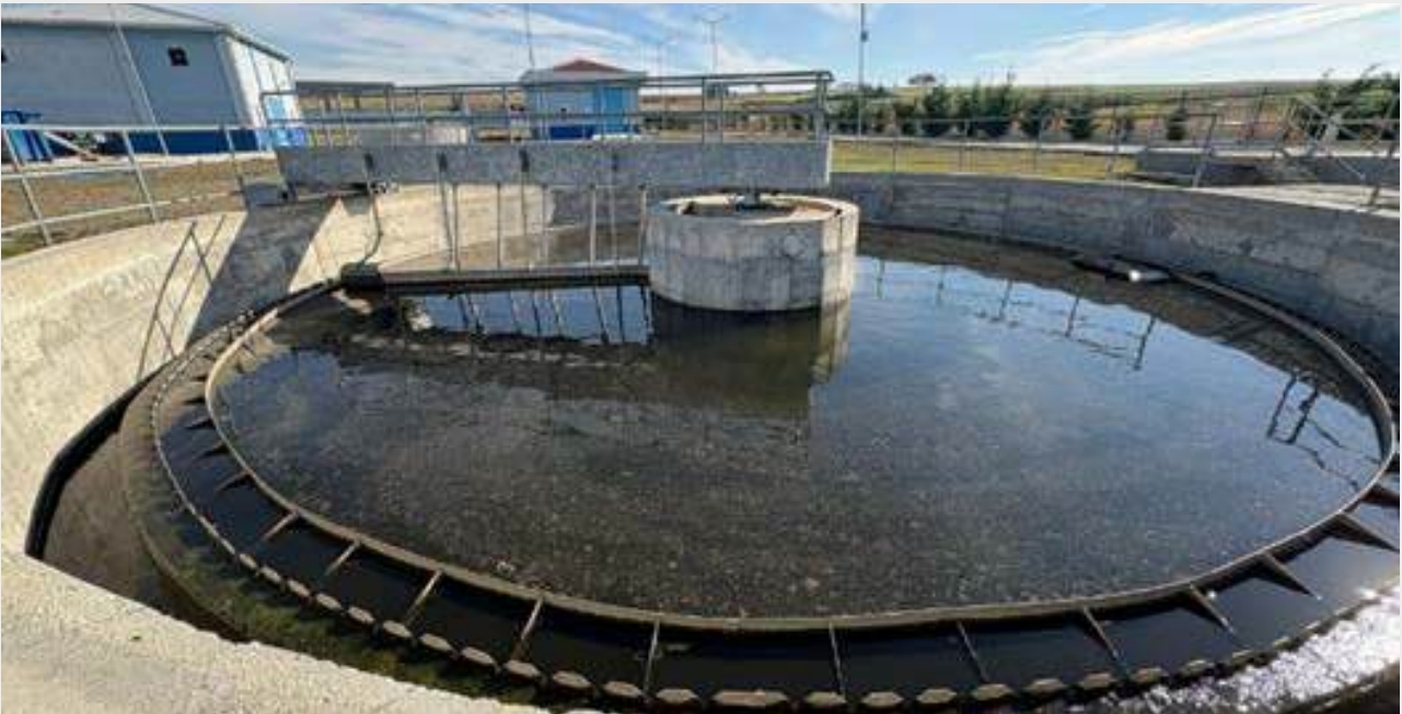
Biyolojik arıtma tesisi çöktürme havuzu
